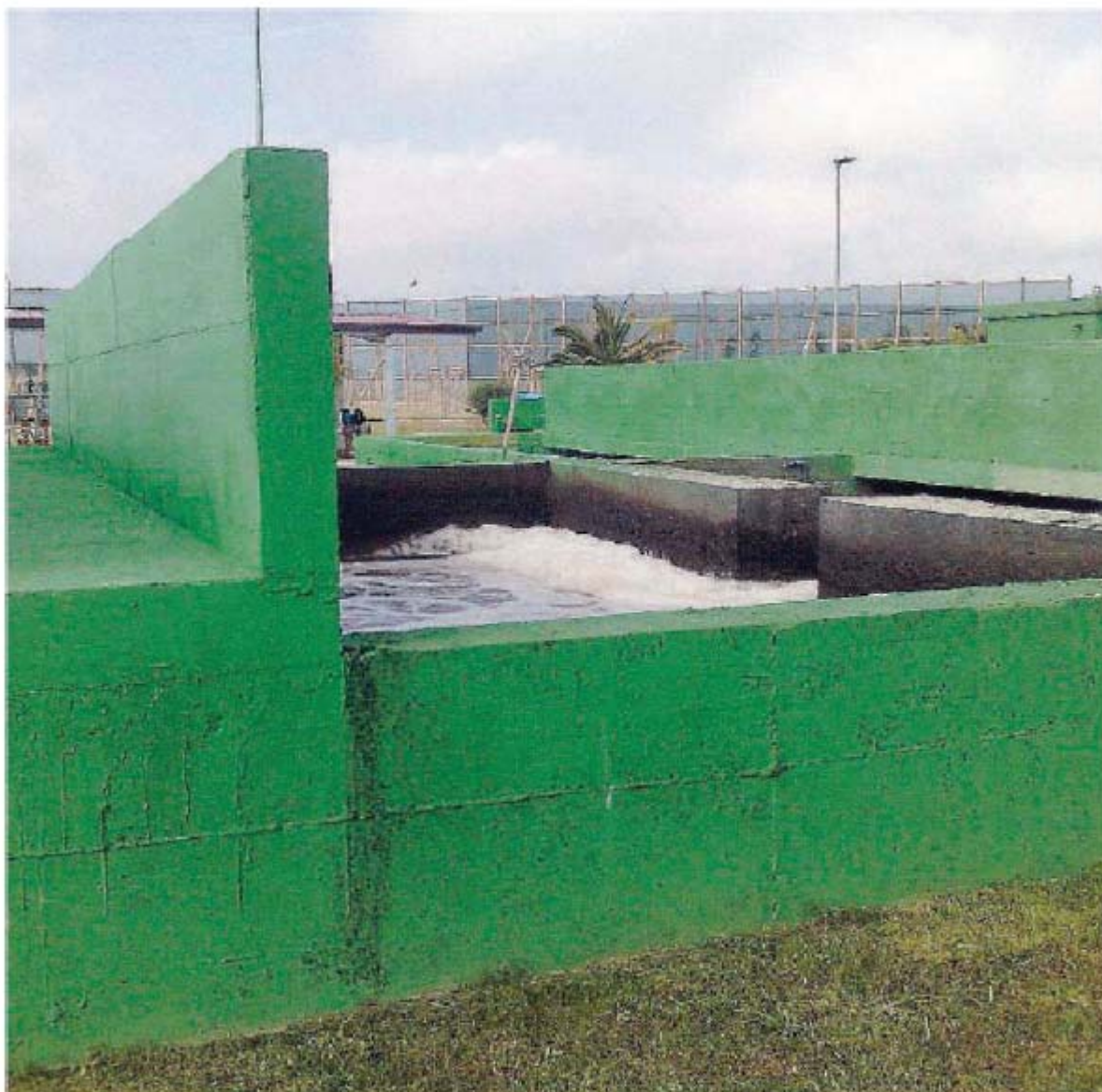
Il depuratore di Milazzo. Il potenziamento dell'impianto di Fossazzo costerà cinque milioni
